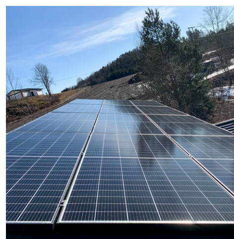
Solcellanlegget på garasjetaket har en effekt på sju kWp
