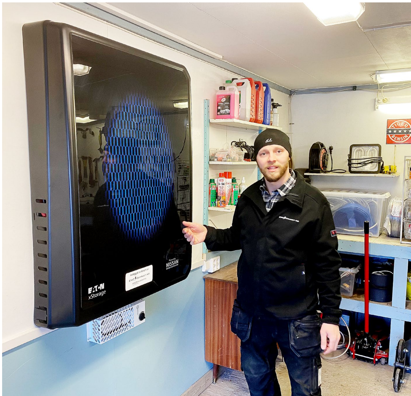
Batteripakken fra Eaton henger på garasjeveggen til Joachim Øvertungset i Holmestrand
