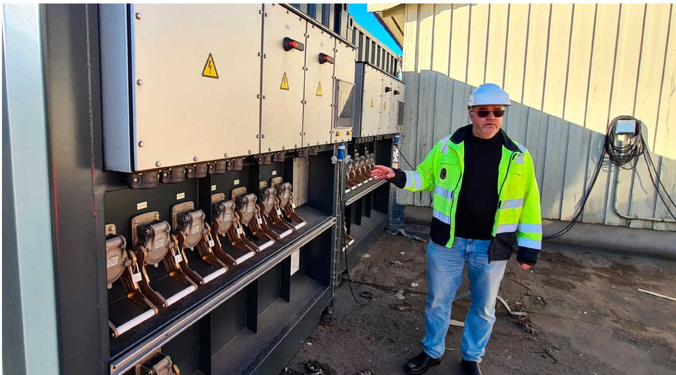
Landstrømanlegget til Borg Havn forsyner skipene som ligger til kai
