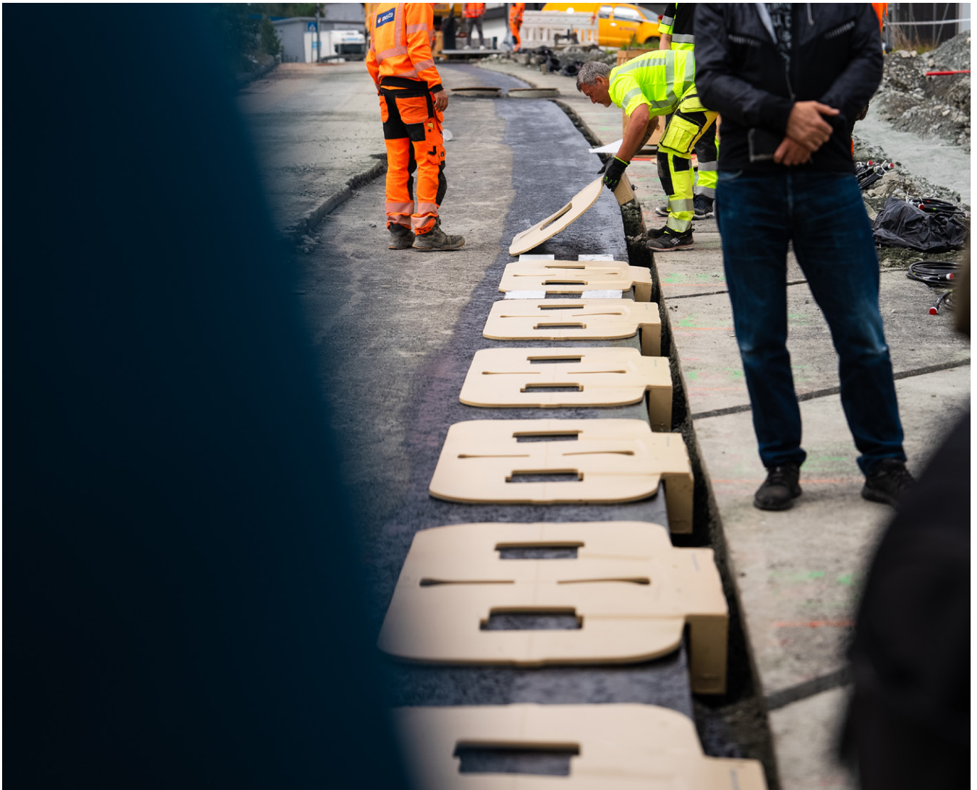
EL-VEI. I el-veien blir det lagt ladeplater og kabler. Etter asfaltering ser den ut som en vanlig bilvei
