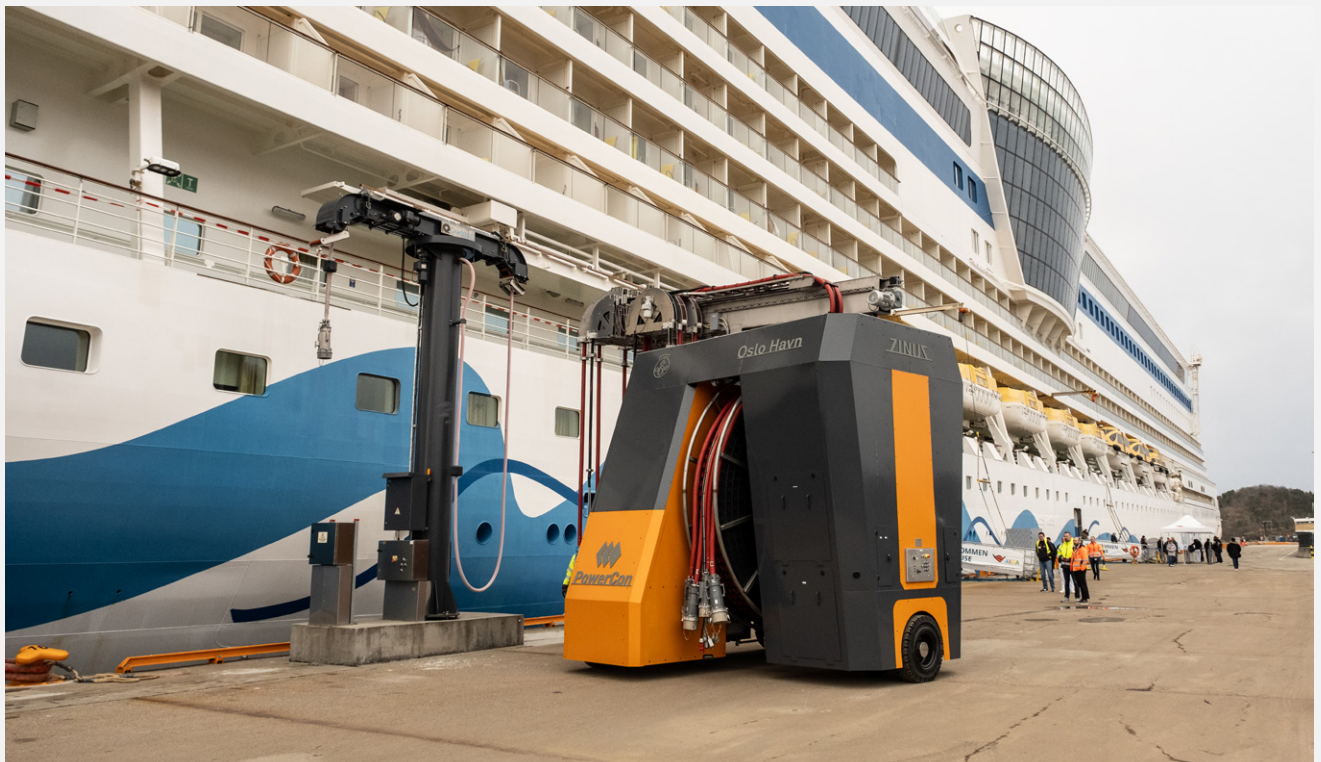
Landstrømanlegget for cruiseskip på Revierkaia i Oslo
