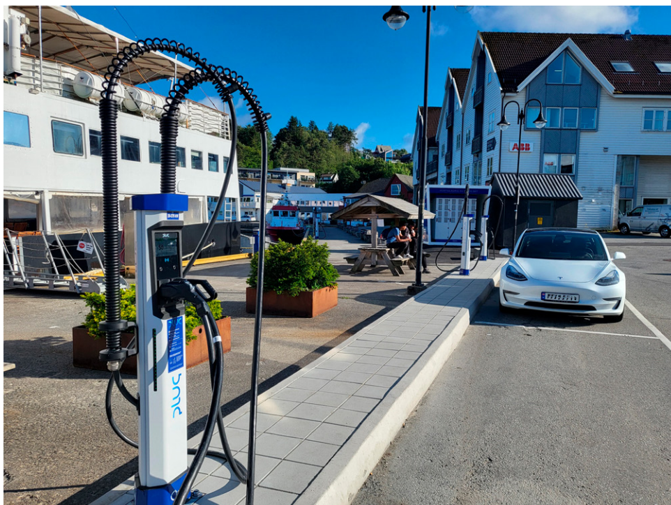
I Leirvik havn har Plus installert lynladere for både elbiler og -fartøy
