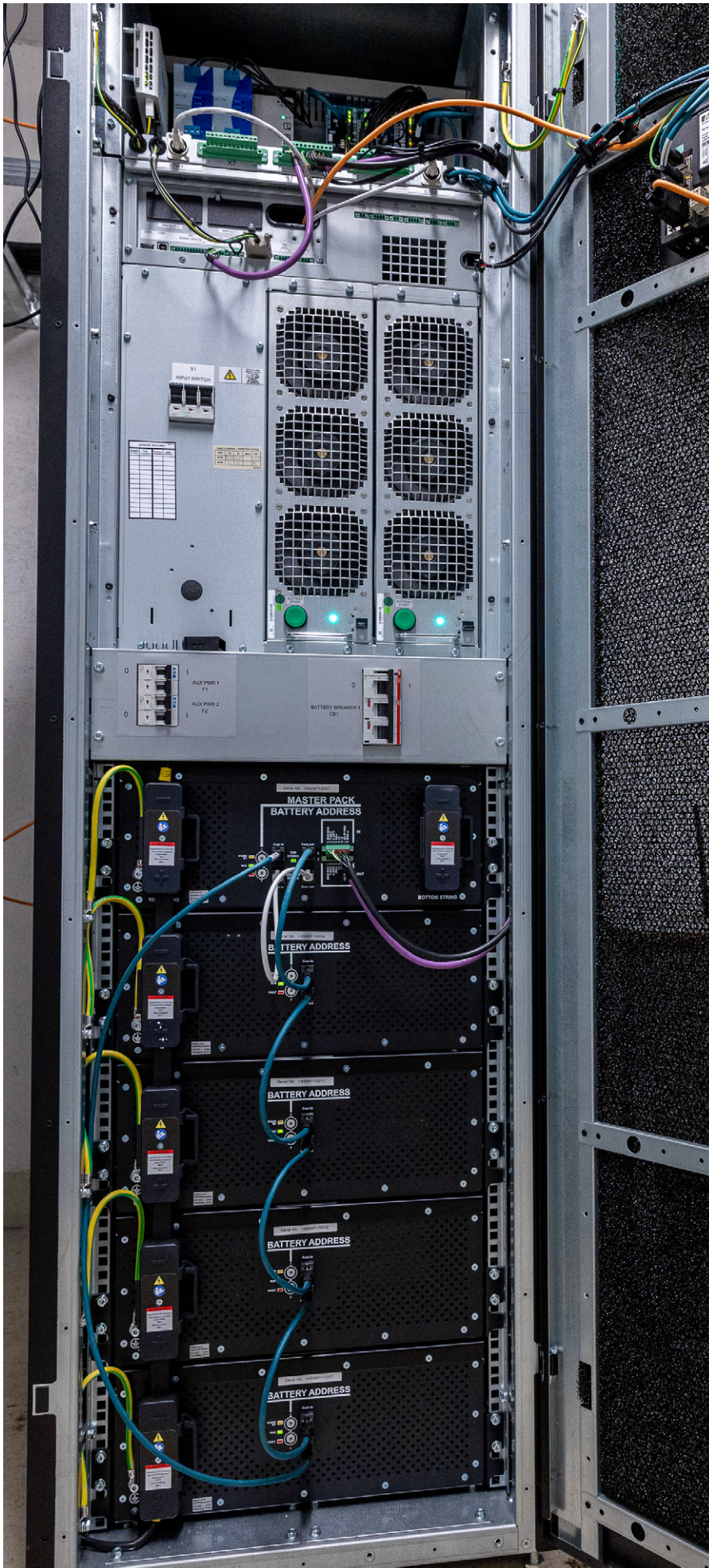
SOL-BATTERI. Solenergien blir lagret i en xStorage-løsning i kjelleren
