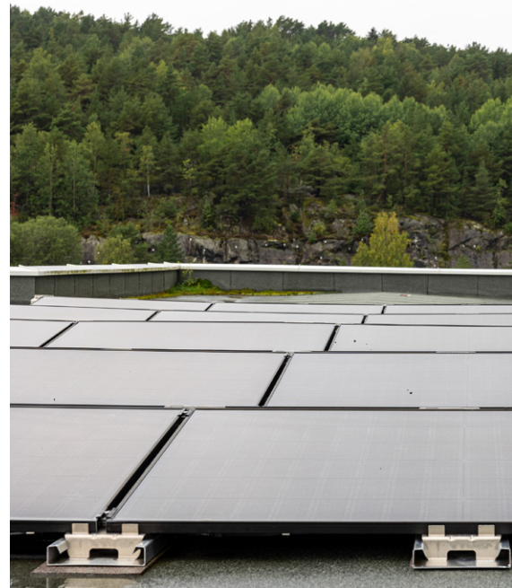
KORTREIST ENERGI. Solenergianlegget på taket av kontoret til
