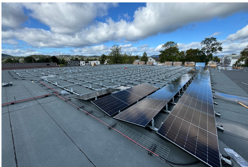
Solcelleanlegget på taket av Ibsenhuset i Skien reduserer det totale energiforbruket i bygningen med ti prosent. Her har Enova gitt tilskudd til nytt SD-anlegg og solceller
