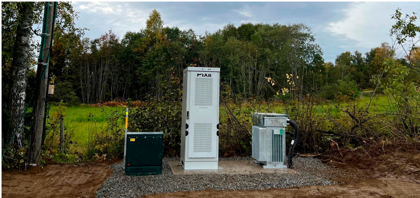
Med batterier og boostere sikrer Elvia strømforsyningen til kunder langt ute i nettet
