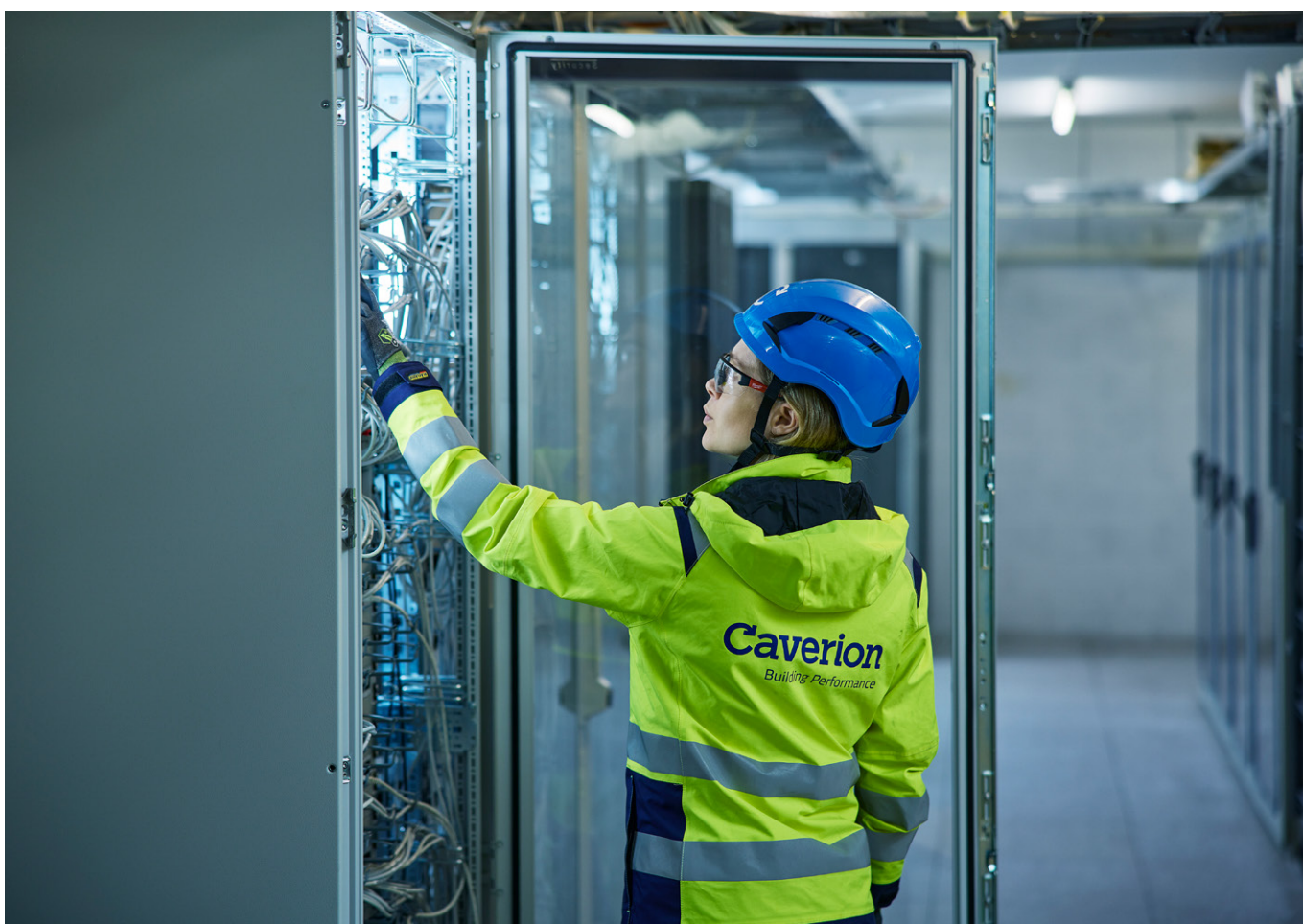
Caverion skal bidra til å sikre stabil drift, og videreutvikling av Telenor Towers Norway sine anlegg
