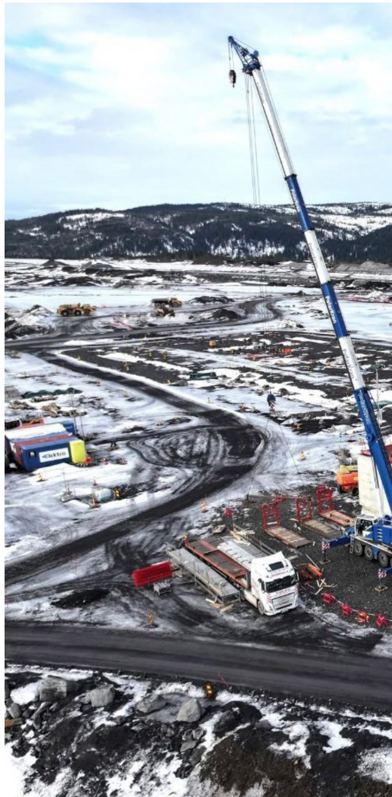
ENERGISENTRAL. Bodø Elektro skal blant annet utføre
