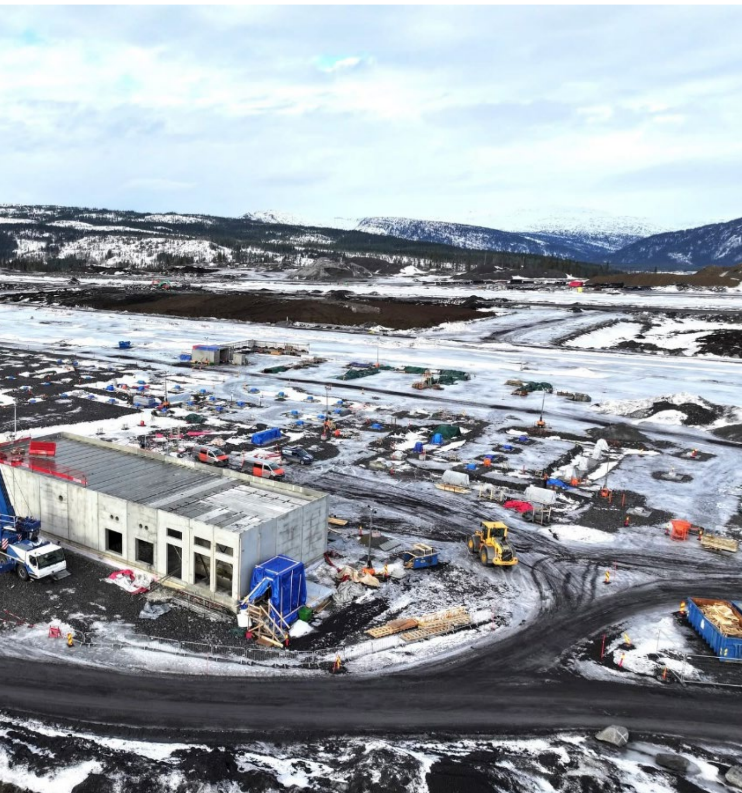
tekniske installasjoner i energisentralen på den nye flyplassen i Mo i Rana
